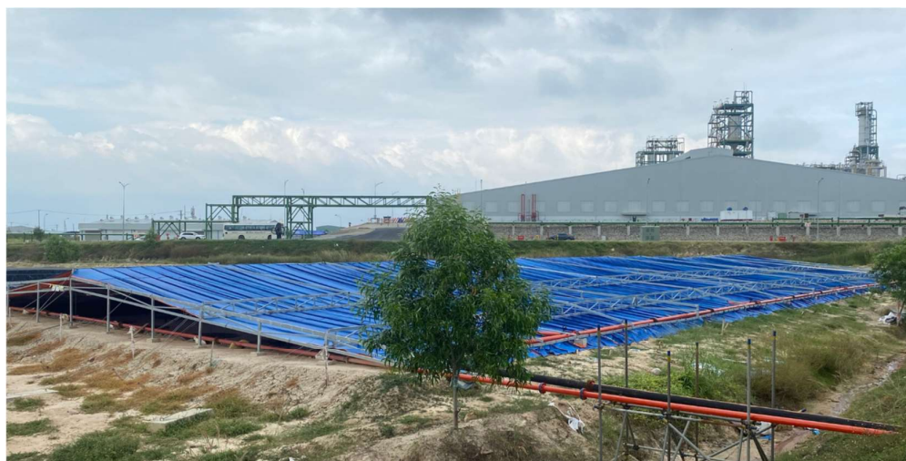
Hình 1.10: Bể chứa tạm thời nước thải vệ sinh bằng hóa chất – Gói thầu A1
