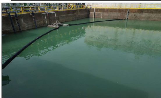
Hình 1.2: Bể chứa nước thử thủy lực và làm sạch đường ống
